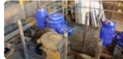
Les servomoteurs BERNARD CONTROLS utilisés pour motoriser les ventelles (+22m)
